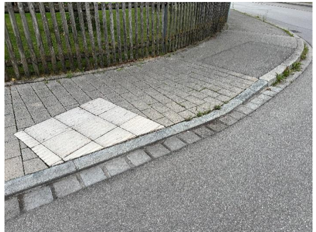
immer öfter sieht man diese Gehwegabsenkungen an Überwegen
