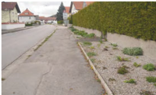
Gestaltungsmängel des Gehwegs in der Münchener Straße
